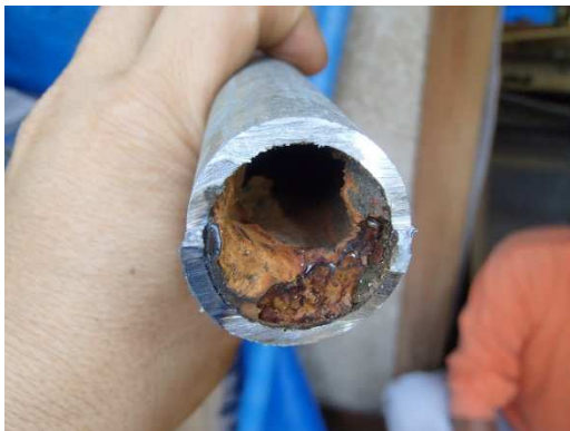
給水管内の錆
